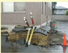
図-4 2016年熊本地震における液状化現象により地中に埋設された埋設管が浮上した様子（左：一般財団法人消防防災科学センター）
