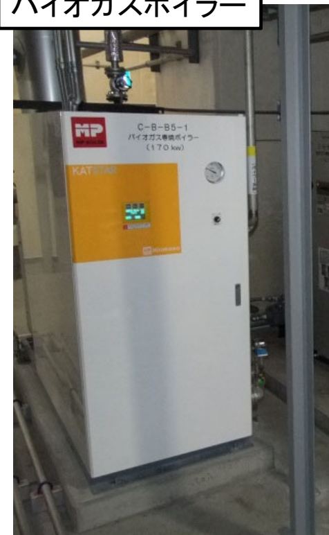
バイオガスボイラー
